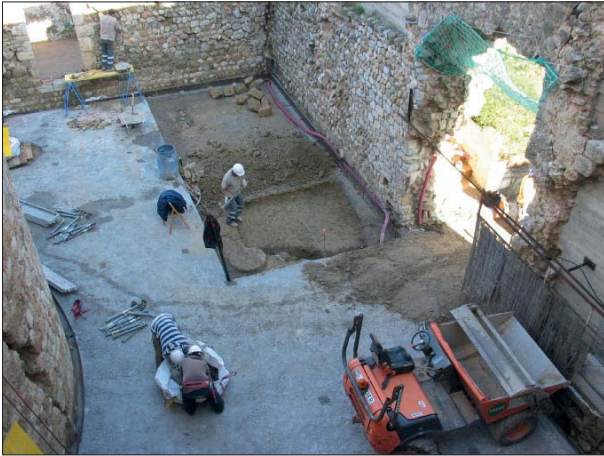
Fig. 6. Emplaçament de la cala feta a tocar de la porta est d'entrada al castell, per a documentar les estructures antigues
